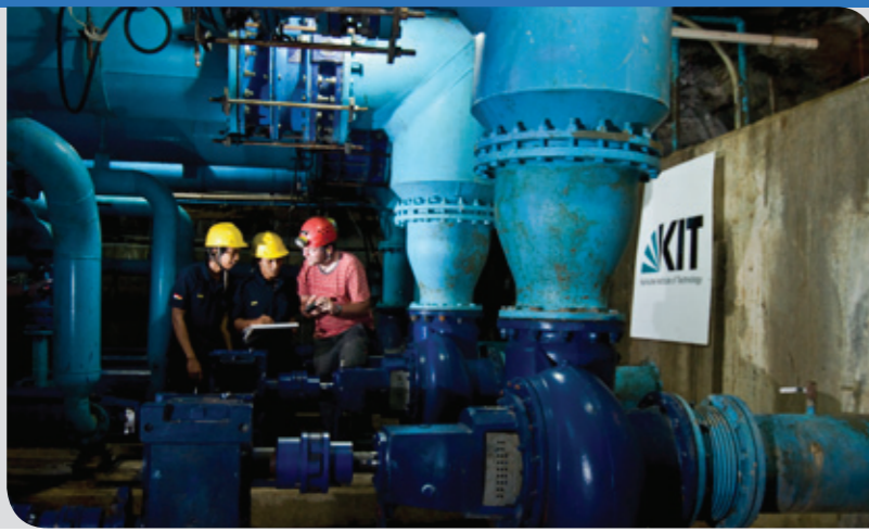
Unterirdische regenerative Wasserförderanlage in der Höhle Bribin, Java, Indonesien (100 m untertage)
